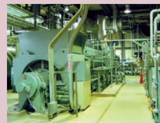
▲ガスエンジン発電機
