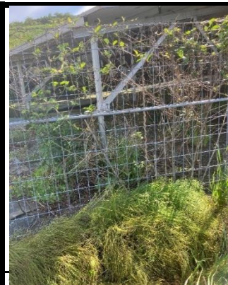
フェンス① 草がフェンスに絡んでいる。
