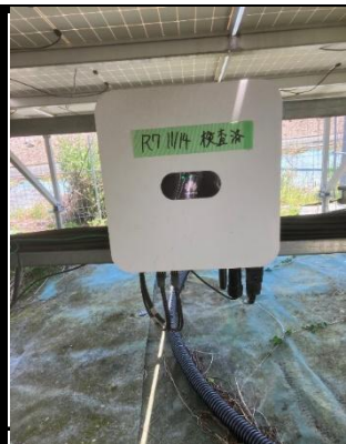
パワコン④ 異常なし。
