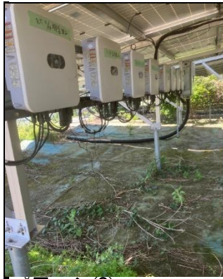
パワコン② 異常なし。
