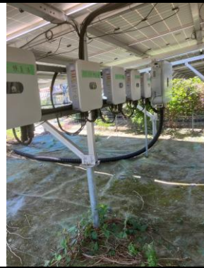
パワコン③ 異常なし。
