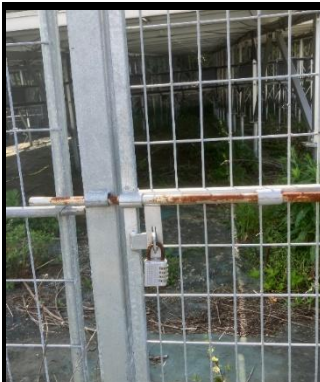
施錠状態 施錠はできているが南京錠も錆が出ている。
