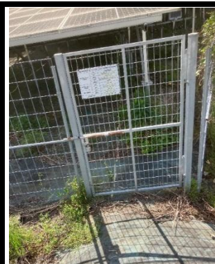
門扉 少し錆が出ている。
