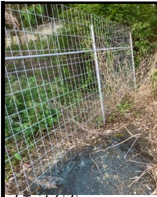
フェンス② 枯草が絡んでいる。
