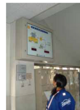
発電量表示盤から発電量を計測している様子
